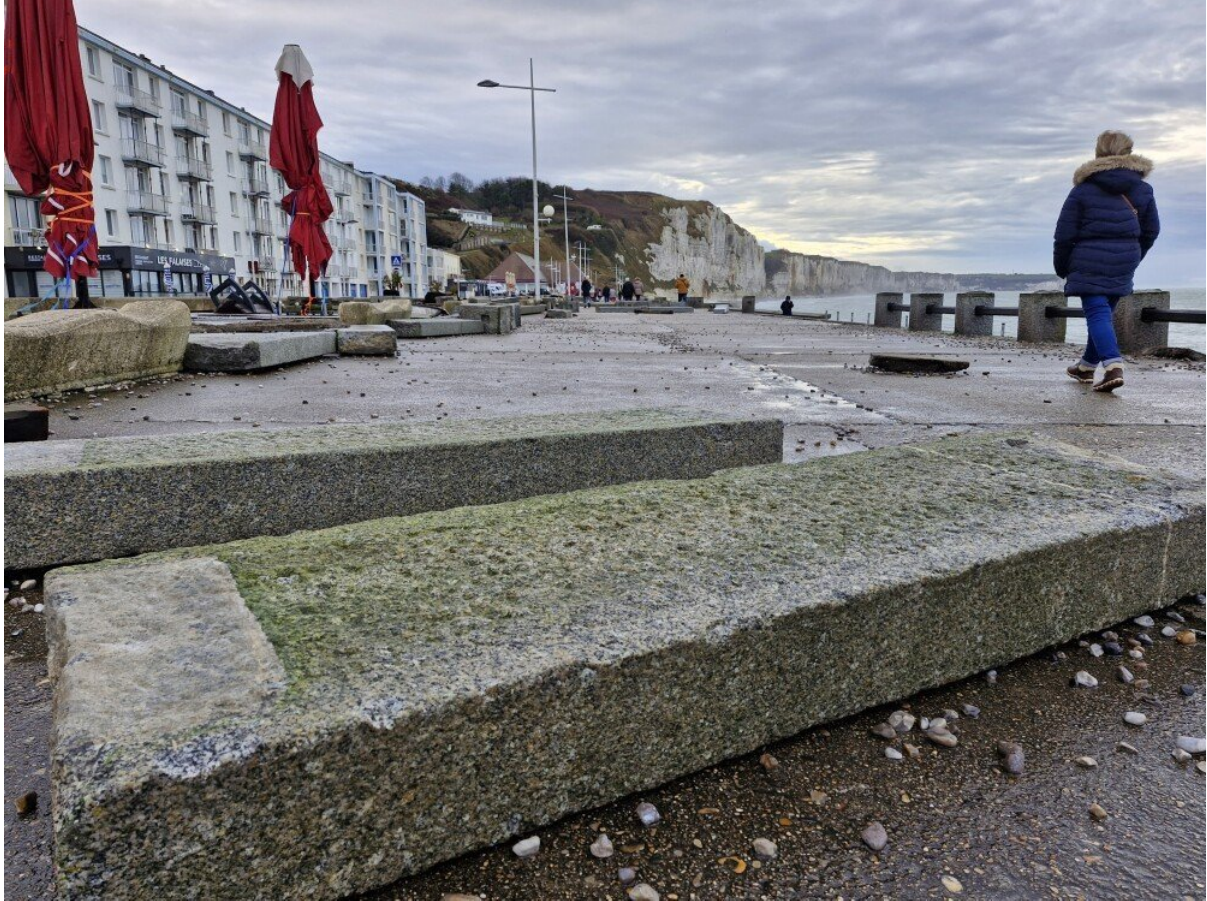
Les blocs de granit de la digue ont été soulevés par la houle. - Célia Caradec
