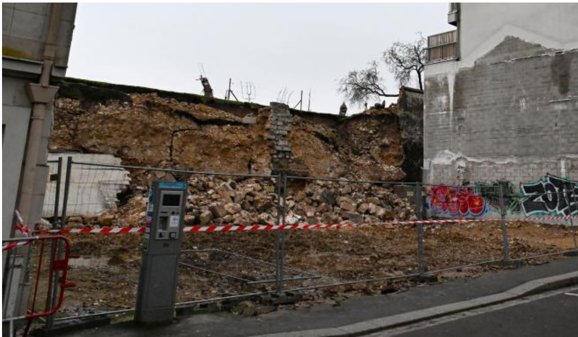
25 mètres de rempart se sont effondrés boulevard de Verdun à Rouen - PND
