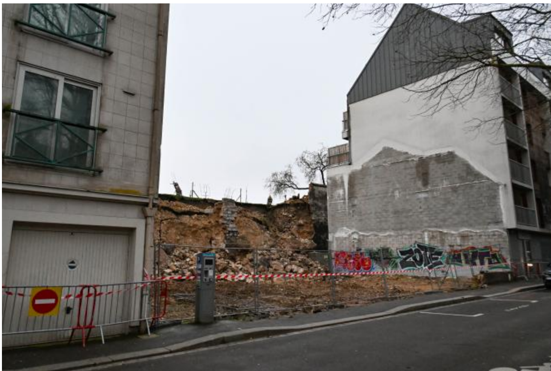
25 mètres de rempart se sont effondrés boulevard de Verdun à Rouen - PND
