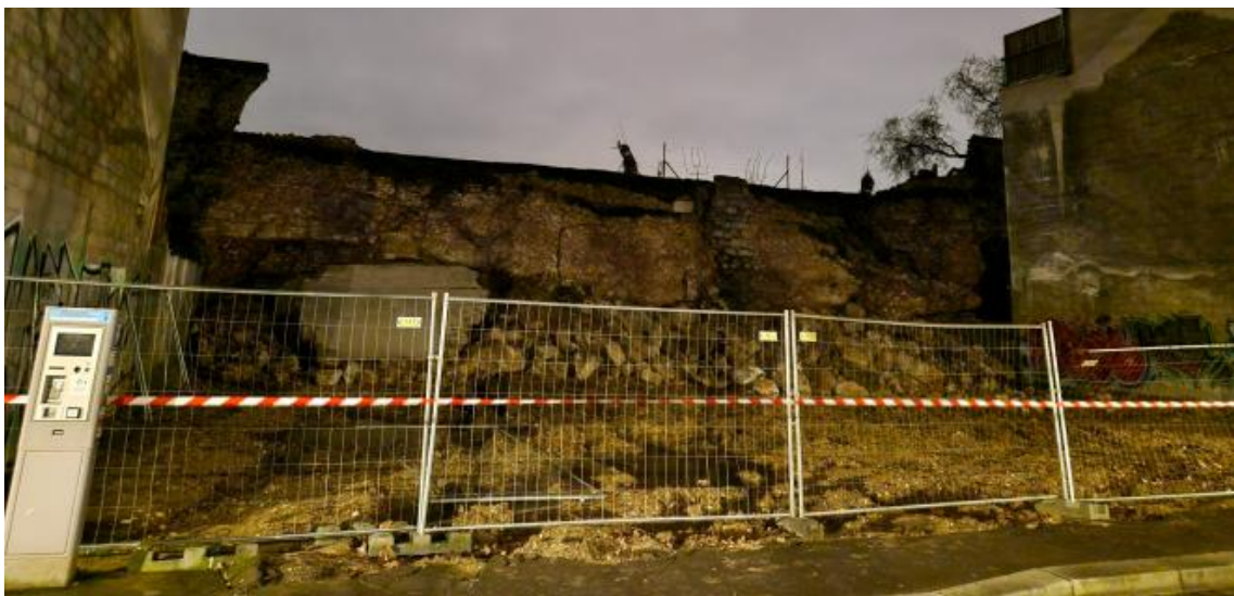
Vingt-cinq mètres de remparts historiques de Rouen se sont effondrés jeudi 19 février 2026. - Paris Normandie
