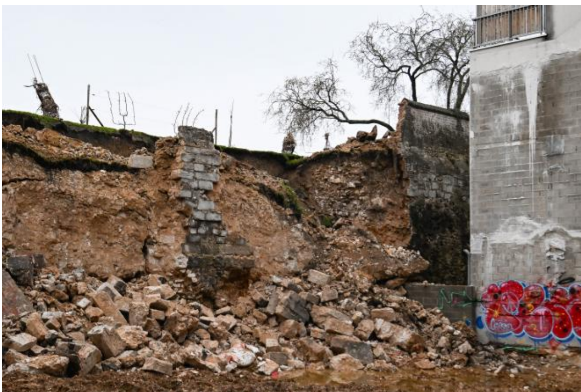
25 mètres de rempart se sont effondrés boulevard de Verdun à
