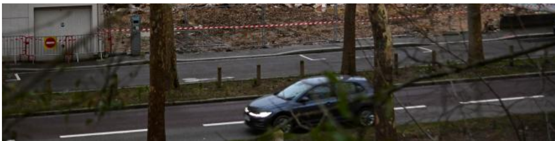
25 mètres de rempart se sont effondrés boulevard de Verdun à Rouen - PND
