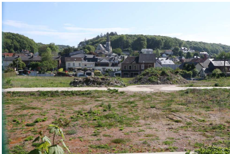
Les deux tas de gravats pollués qui restent sur le site vont être évacués
