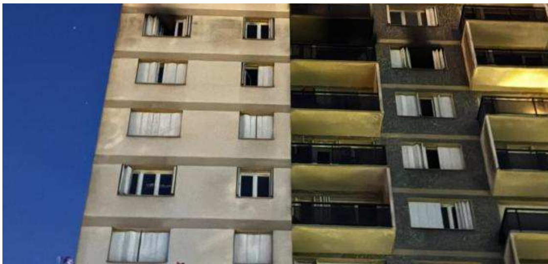
L'immeuble porte les stigmates de l'incendie. - Photo DR
